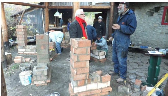
Figura 5: construcción de chimeneas de combustión rocket en una capacitación en El Bolsón
