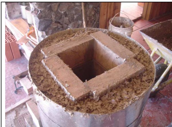
Figura 2a: Encamisado de chapa y aislamiento térmico de la chimenea
